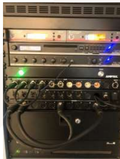
AV-installatie "De Spil"
