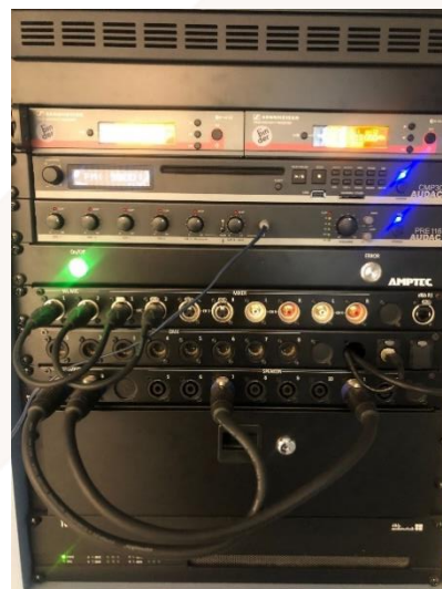
AV-installatie "De Spil"
